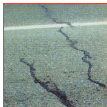
1. La réfection des fissures pages 3 – 5
